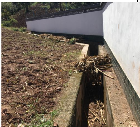
佐戈依达变电站排水现状
