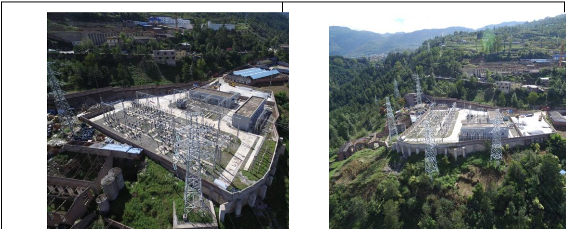
城关变电站现状
