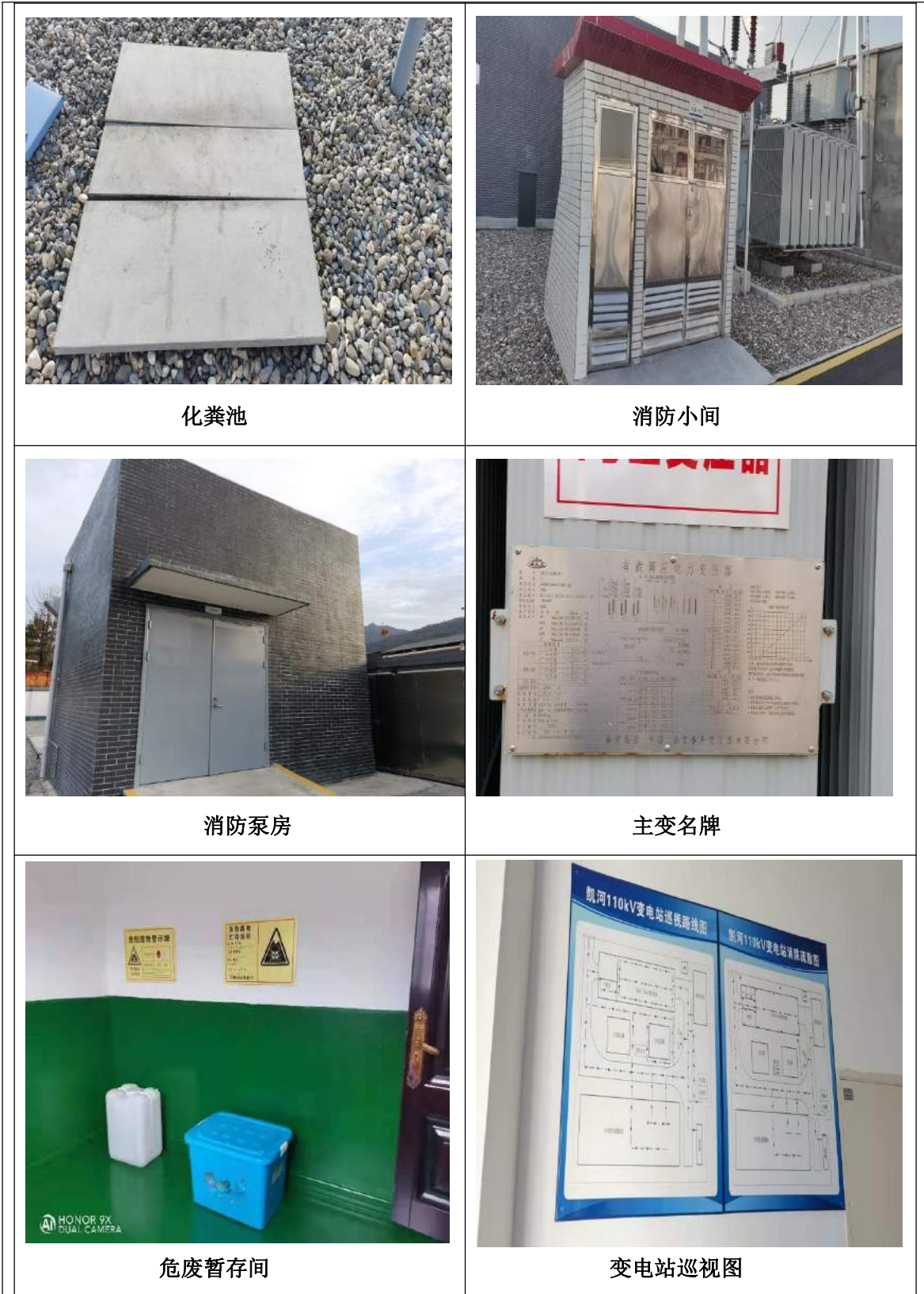
图 4-2 凯河 110kV 变电站站内情况
