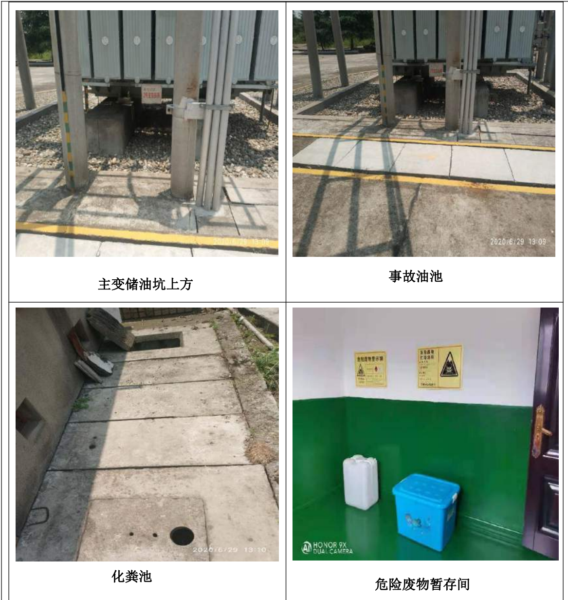
图 4-3 芦溪 110kV 变电站站内情况
