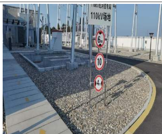
110kV 开关设备场
