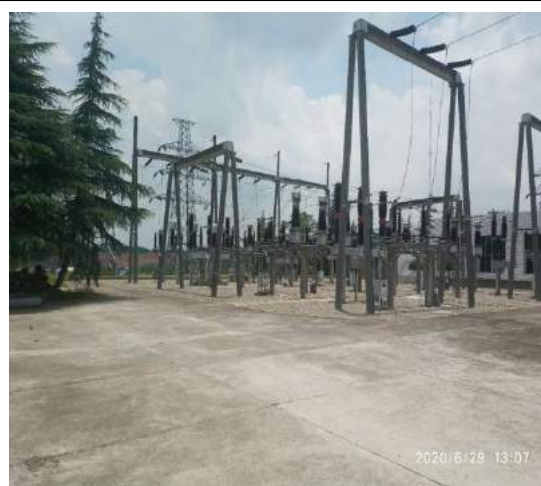
110kV 开关设备场
