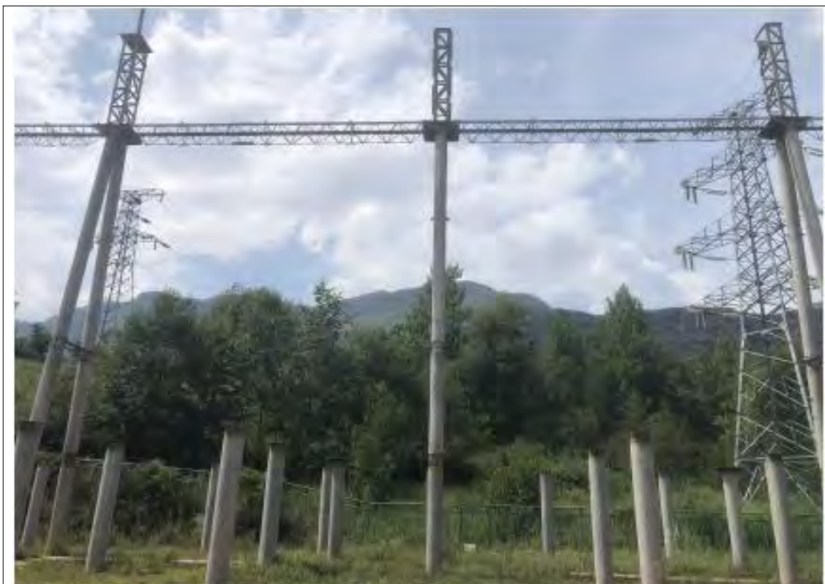
拉木阿觉变电站预留出线间隔 (7Y)
