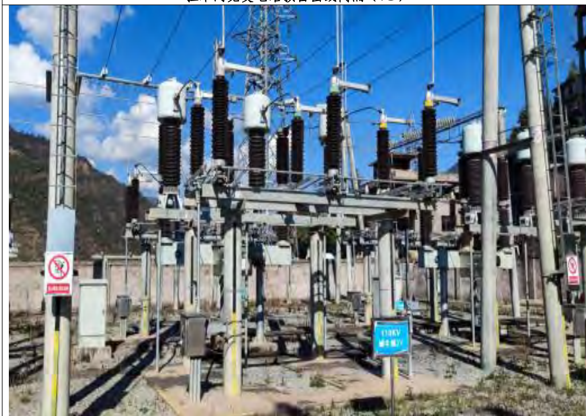
城关 110kV 变电站预留出线间隔 (城牛线 2Y)
