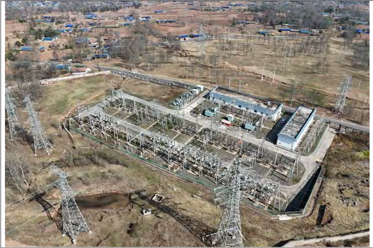
拉木阿觉 110kV 变电站
